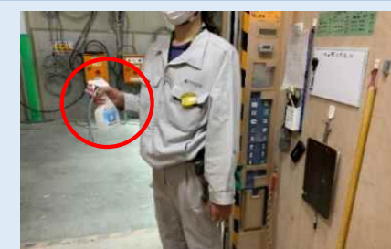
EVの操作盤等の消毒を徹底
